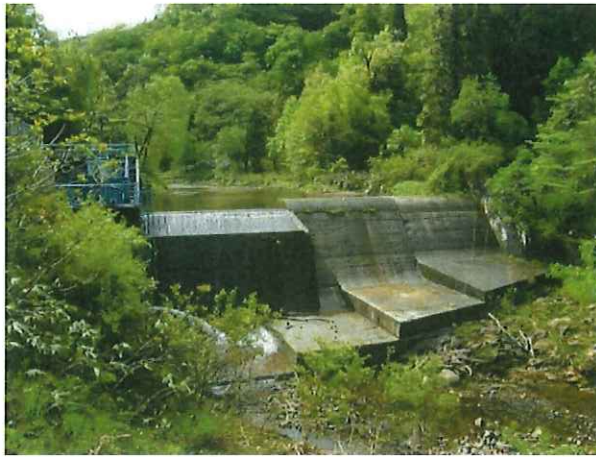
チロリアン方式による取水設備の例（その1）
