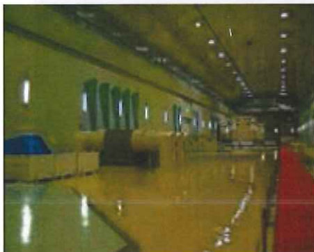
地下発電所（大河内）
