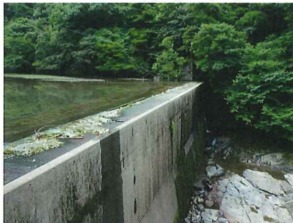
チロリアン方式による取水設備の例（その2）
