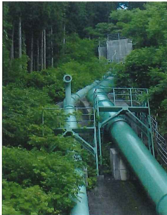
真加子発電所（岡山県企業局）の 水圧管路、及び余水管路（露出管路）
