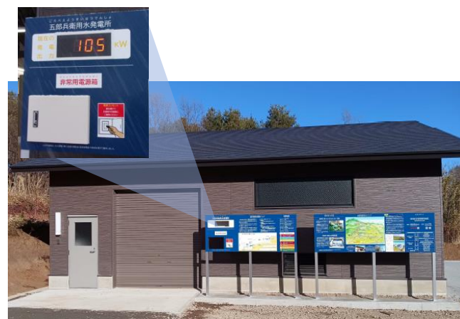
PR看板(出力表示・非常用電源箱)
