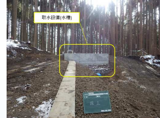
取水設備(水槽)
