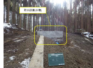
取水設備(水槽)
