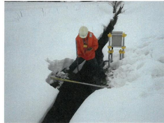
水位計設置状況
