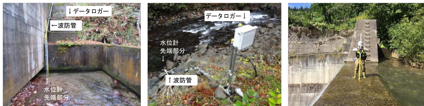
図. 水位計設置状況(A 地点: 左図、B 地点: 中図)、流速観測の様子(A 地点: 右図)
