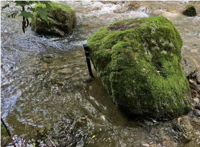
絶対圧水位計設置状況
