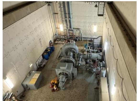
水車及び発電機全景
