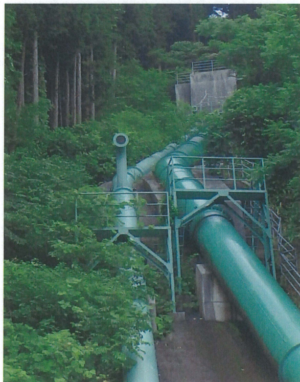
写真 7-1-3 真加子発電所（岡山県企業局）の 水圧管路、及び余水管路（露出管路）
