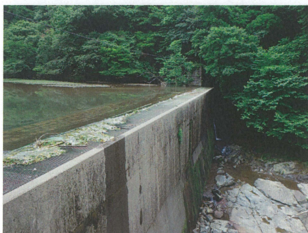
写真 7-1-2 チロリアン方式による取水設備の例（その 2）
