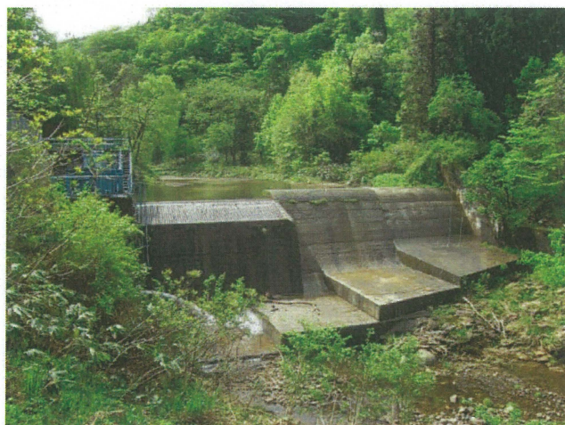
写真 7-1-1 チロリアン方式による取水設備の例（その 1）
